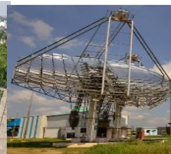
NETRA Solar Thermal
